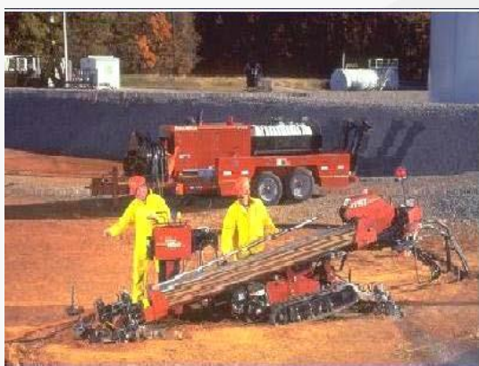
سوراخ کاری زیر مخزن به منظور نصب آندهای اعمال جریان
