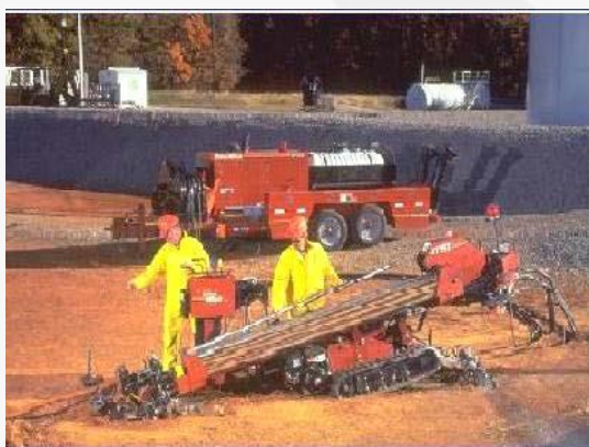
سوراخ کاری زیر مخزن به منظور نصب آندهای اعمال جریان
